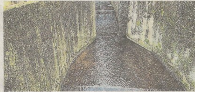
De l'eau brute pompée retourne vers le ruisseau. Une vanne en régule le débit.
