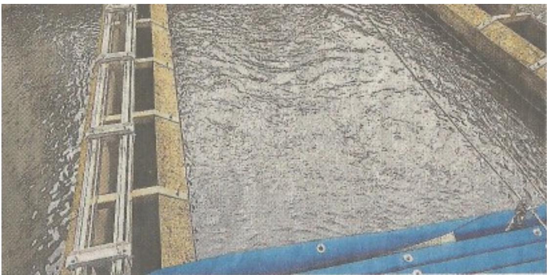
L'un des sept filtres à sable par lequel passe l'eau en continu à l'usine d'eau.
