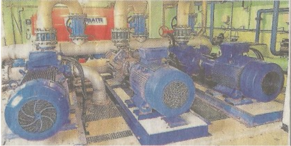
Les trois immenses pompes de l'usine du Lac au Duc refoulent l'eau potable vers les châteaux d'eau.
